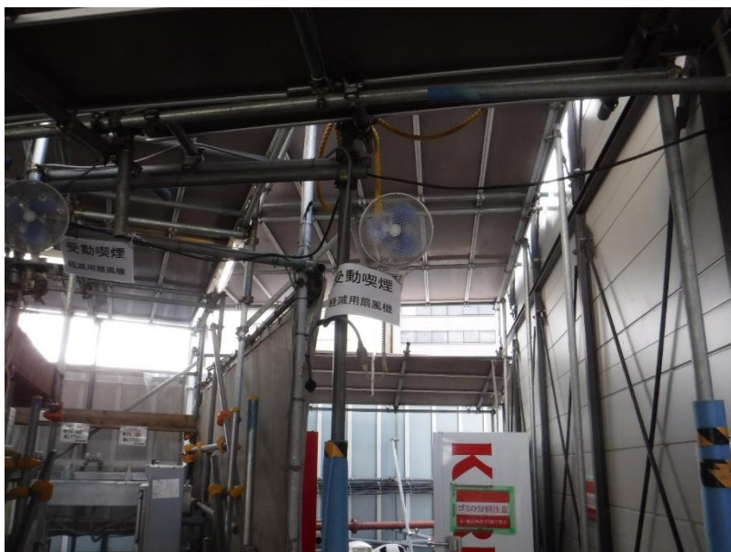
写真 37 受動喫煙対策として通路内に扇風機を設置
